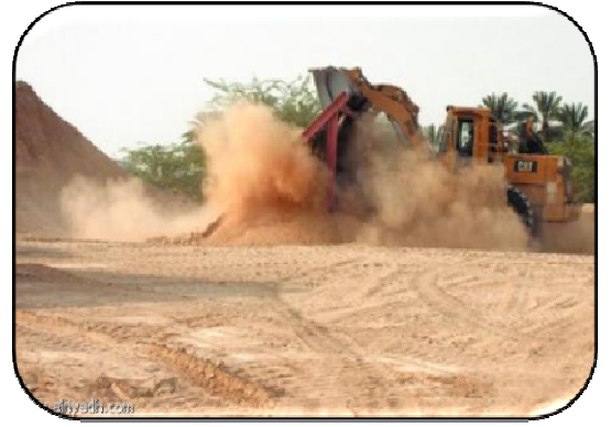
- تلوث البيئة بسبب الضوضاء الناتجة عن ورشات البناء -
